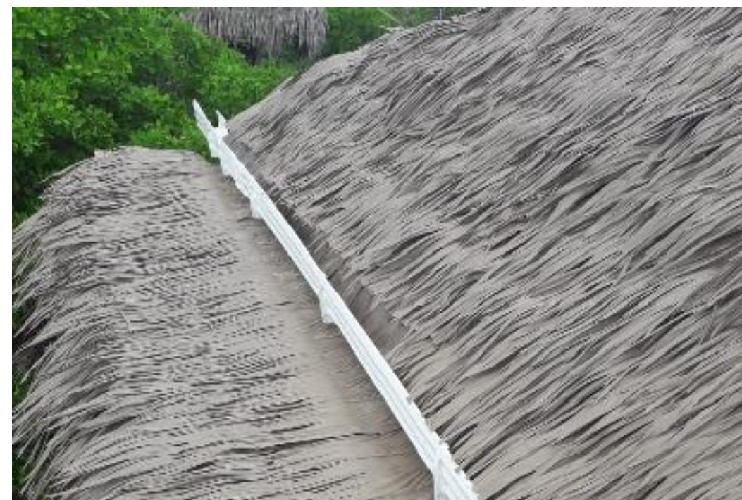
CANAL COLECTOR DE AGUA LLUVIA EN TECHO DE PALMA SINTETICA
