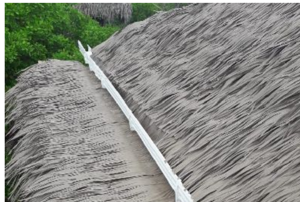
CANAL IMPROVISADO COLECTOR DE AGUA LLUVIA EN TECHO DE PALMA SINTETICA
